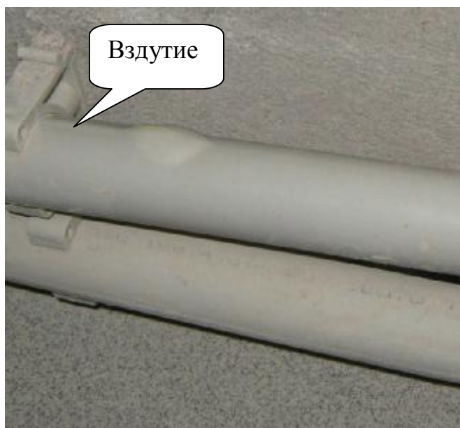
Рис. 1.3. Фотография фрагмента полипропиленовой трубы, установленной в системе отопления жилого дома со вздутием на её внешней поверхности.
